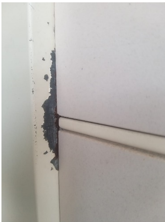
Фото 1. Коррозия оцинкованного откоса проема
