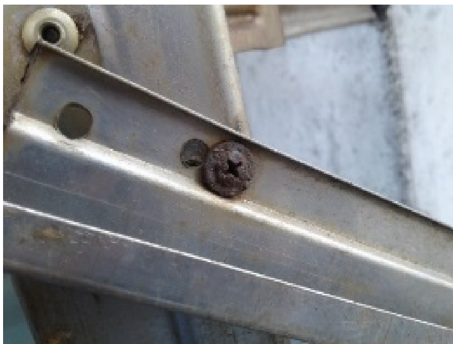
Фото. Коррозионное разрушение оцинкованного самореза
