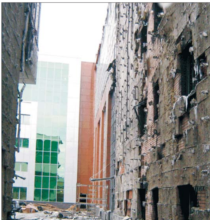
Общий вид фасада офисного здания после пожара (Москва, 1-й Дербенёвский пер., д. 5)
