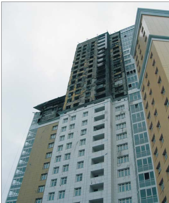
Общий вид фасада 30-этажного многоквартирного дома после пожара (Москва, ул. И. Бабушкина)
